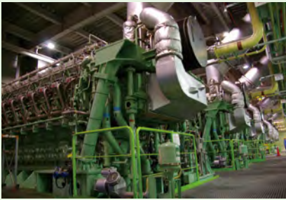
出力5,750kwのガスエンジン 発電機を6基備える
